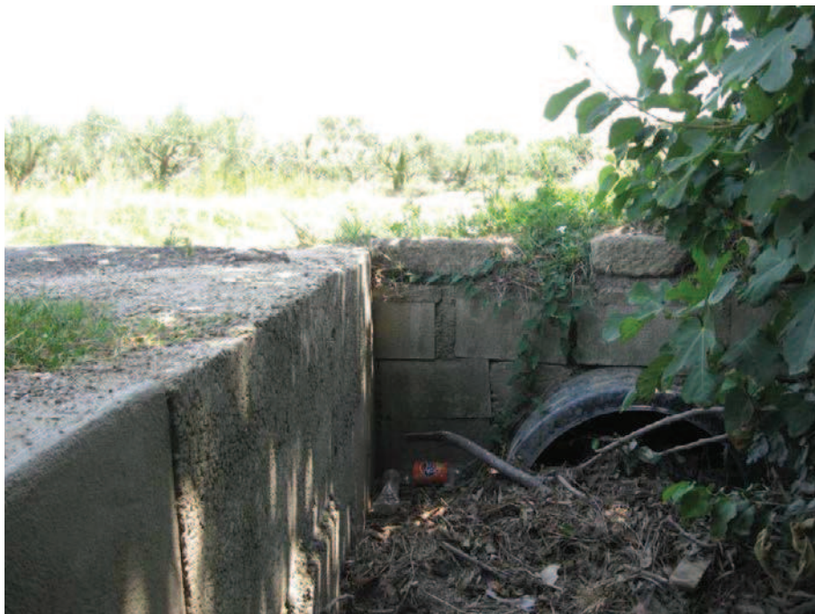
Figure 8 : Section d'un fossé réduite par des débris.
