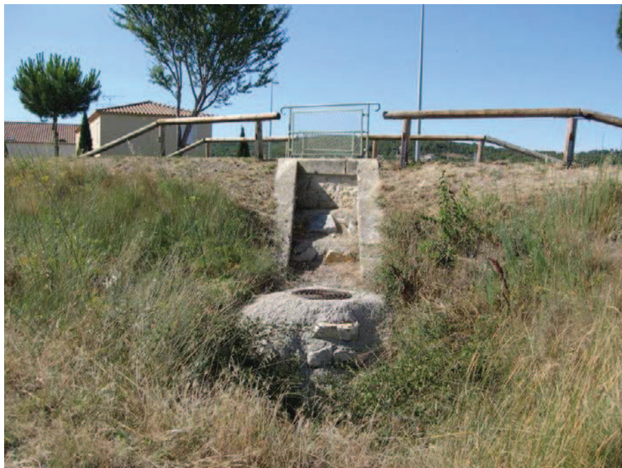
Figure 4 : Remblai transversal de l'ancienne voie ferrée, exutoire totalement obstrué.
